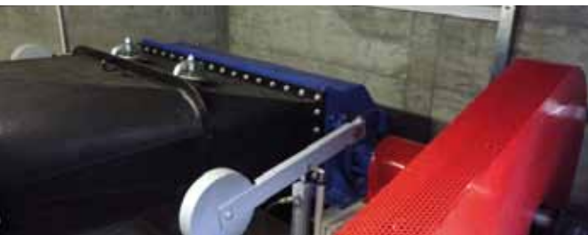
Turbinenhaus mit gekapselter Turbine
