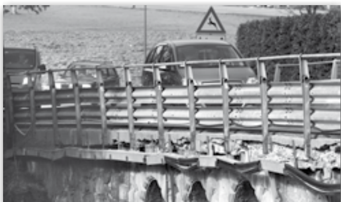
) Denkmalschutz oder nicht - die Brücke braucht auf jeden Fall eine Sanierung. (Foto: „SQ“/rb)
