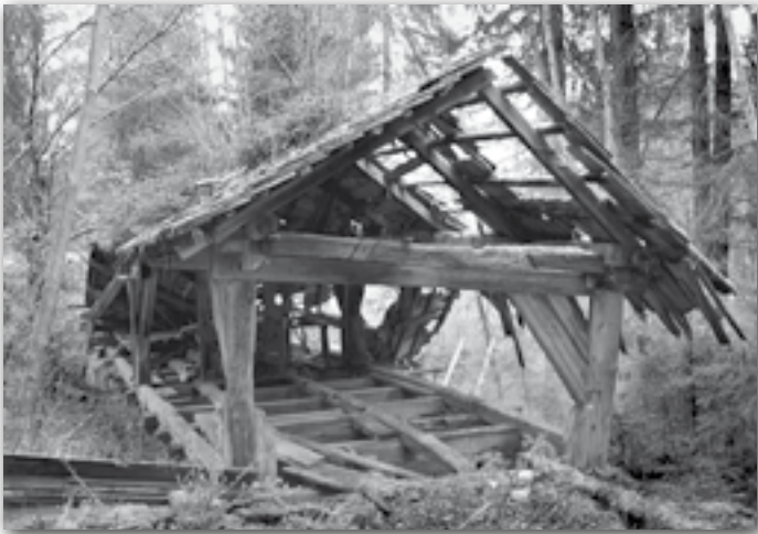
) An der historischen Säge besteht dringender Sanierungsbedarf. (Foto: „SQ“/rb)
