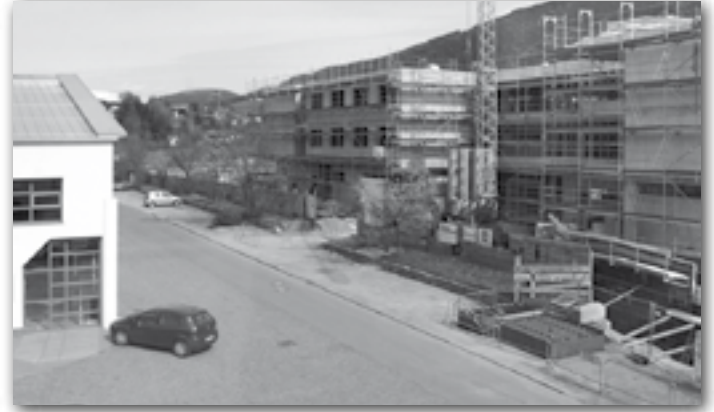
) Sobald die Außengestaltung des Pflegeheims ansteht, sollen gleichzeitig auch die Infrastrukturen am Gamperweg erweitert werden. (Foto: „SQ“/rb)
