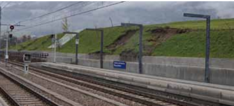
Entlang des Fußgängerweges von Mitterolang zum Bahnhof sind kleinere Muren von der darüberliegenden Böschung abgegangen
