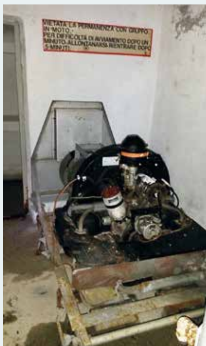
Der Notstromgenerator im Bunker Nr. 9 in Mitterolang (Marer Bunker). Die Leistung des von einem VW Käfer Motor betriebenen Aggregats beträgt 10 kW.
