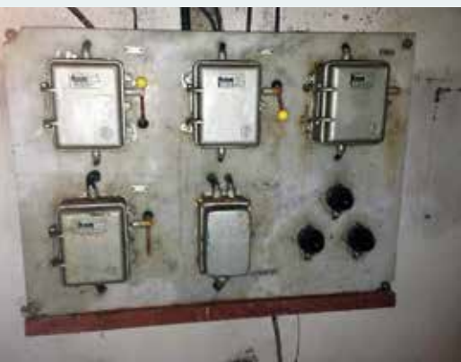
Im Bild die Elektrozentrale in einer reaktivierten Bunkeranlage. Solche Anlagen funktionieren auch heute noch (Fotos: Denis Sagmeister).
