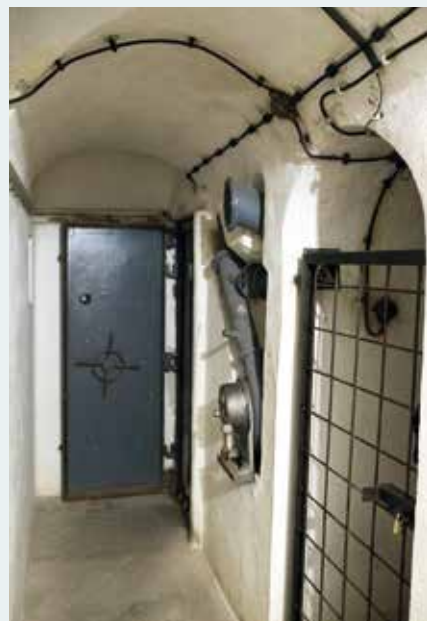
Im Bild der Zugang zu einem Kampfstand. Gut zu erkennen der Handventilator für die Belüftung des Kampfstandes und die originalen Stromleitungen, die auch heute noch die Räume mit Licht und Strom versorgen.
