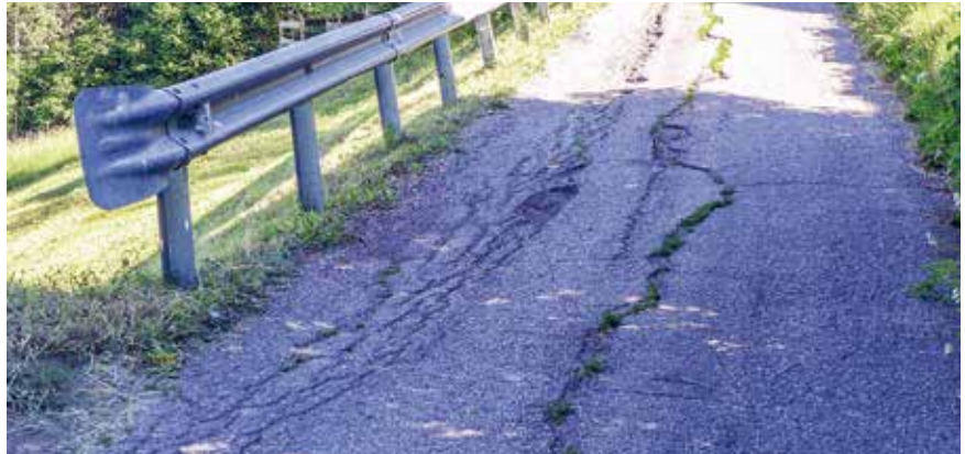
Im Bild die Straßenschäden auf dem Riedweg im Bereich des Eggerhofes.
