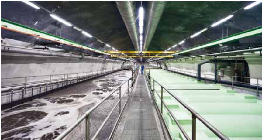
Der Anteil der Gemeinde Olang an den Führungskosten der Kläranlage des Abwasserverbands Mittleres Pustertal beträgt heuer 216.085,50 Euro. Im Bild der Stollen der Kavernenkläranlage Tobl, wo das Abwasser aus Olang geklärt wird [Foto: www.atzwanger.net].
