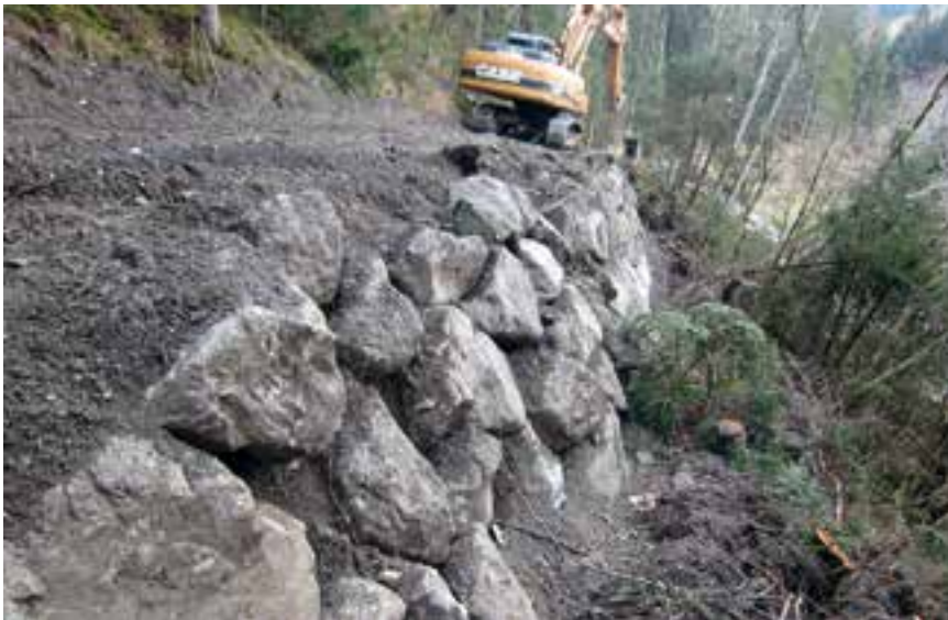
Nach anhaltenden Regenfällen war der Fuß- und Radweg im Bereich Wolfsgrube derart aufgeweicht, dass die entstandenen Schäden umgehend saniert werden mussten (Foto: Team 4).
