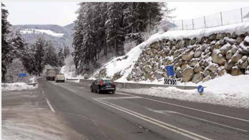
Nach den anhaltenden Regenfällen im abgelaufenen Jahr ist ein Teil der Böschung bei der Stauseekreuzung eingestürzt.
