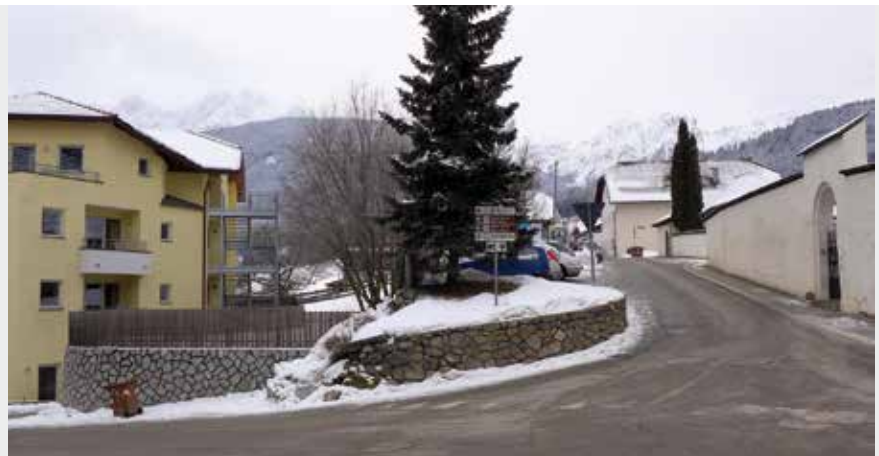
Für die Verlegung von Leitungen bei der Umgestaltung des Dorfplatzes in Niederolang muss die Straße in der Länge zeitweise komplett gesperrt werden.
